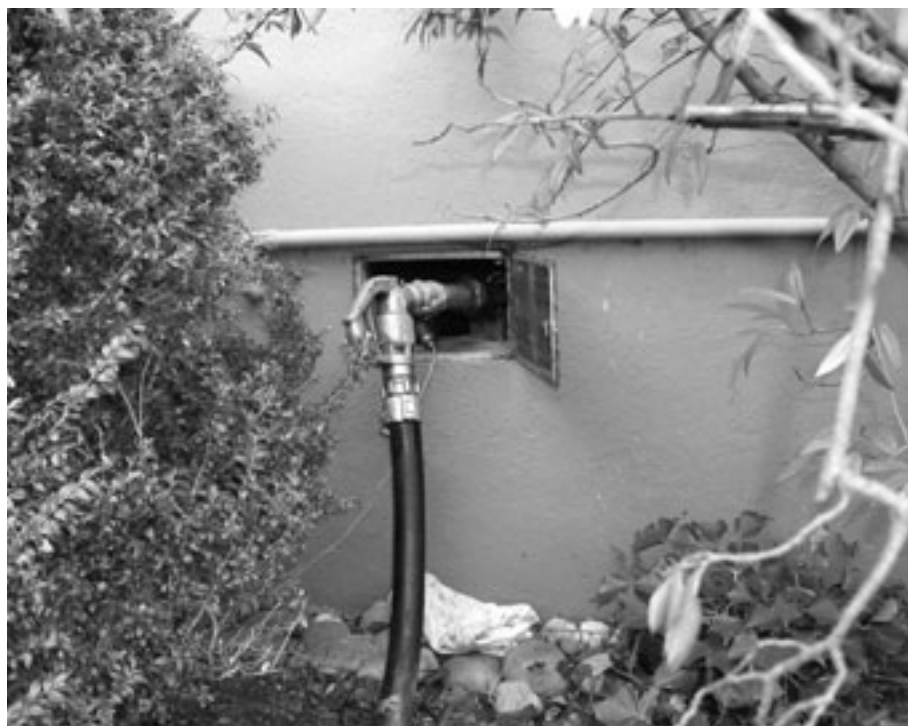
Vorsicht beim Füllen von Tankanlagen verhindert nicht nur Ölfälle, sondern auch hohe Kosten.
